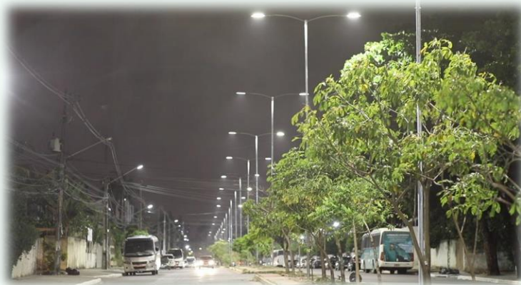
Modernização do sistema de iluminação pública, por lâmpadas LED. Fonte: Prefeitura Municipal de Jaboatão dos Guararapes (PE).
