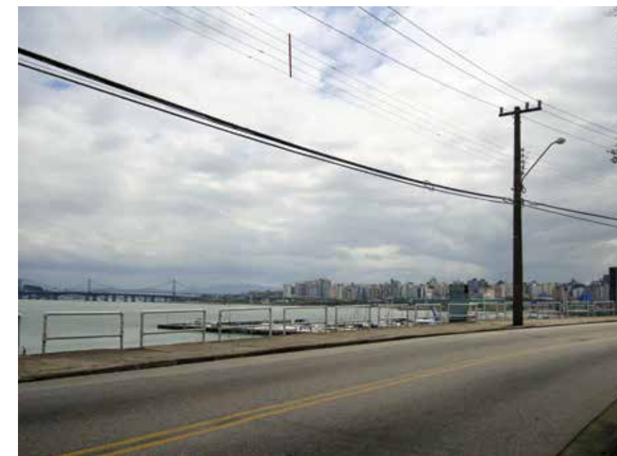
Figura 8.24: Rede elétrica aérea
